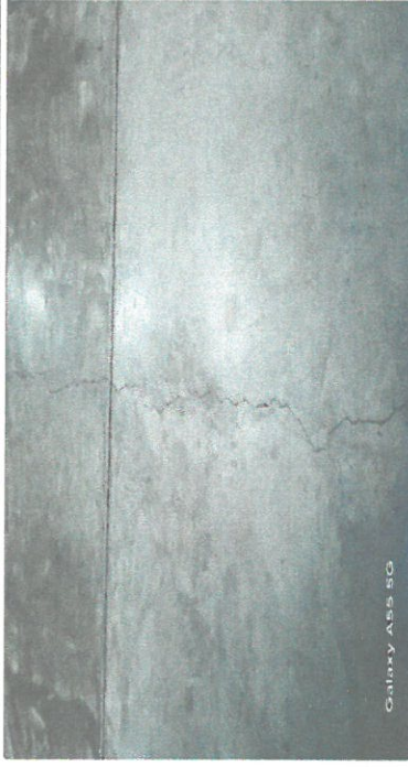
Foto 2: Deterioro en el piso de una de las aulas del modulo 2 aula No 2
