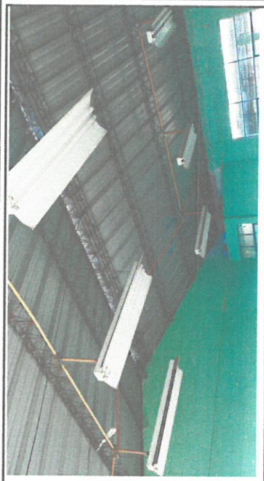
Foto 2: fotografía del modulo No 3 lámparas con deterioro
